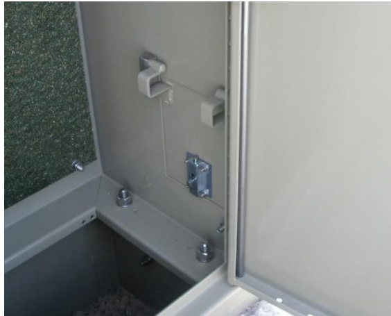
Kabeldoorvoerluik gezien binnenzijde kast
