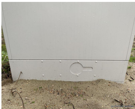
Kabeldoorvoerluik in fundatie
